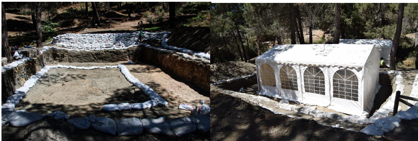
Fotografía 17: Montaje de perímetro de control de aguas de escorrentía y últimas fases de montaje de la cubierta sobre el Sondeo
