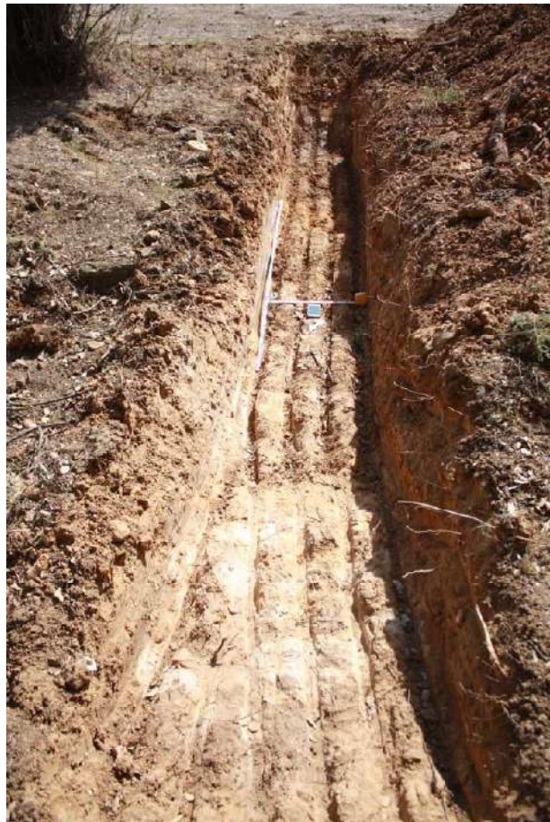
Sondeo 1. Vista desde el SO. Localización de areniscas (geológico) a escasa profundidad.
