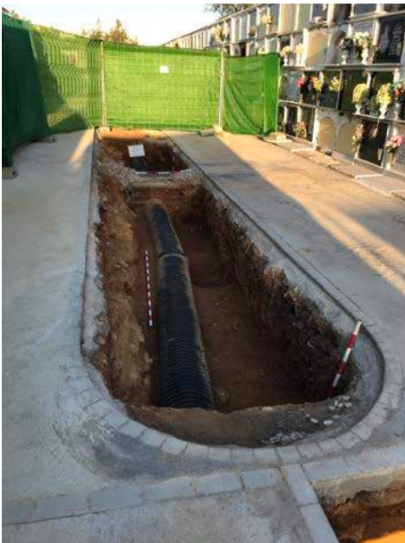
Figura 4.42.- Sondeo 3. Localización de los límites meridional y occidental de la Fosa e incidencia sobre ésta de la instalación de saneamiento.
