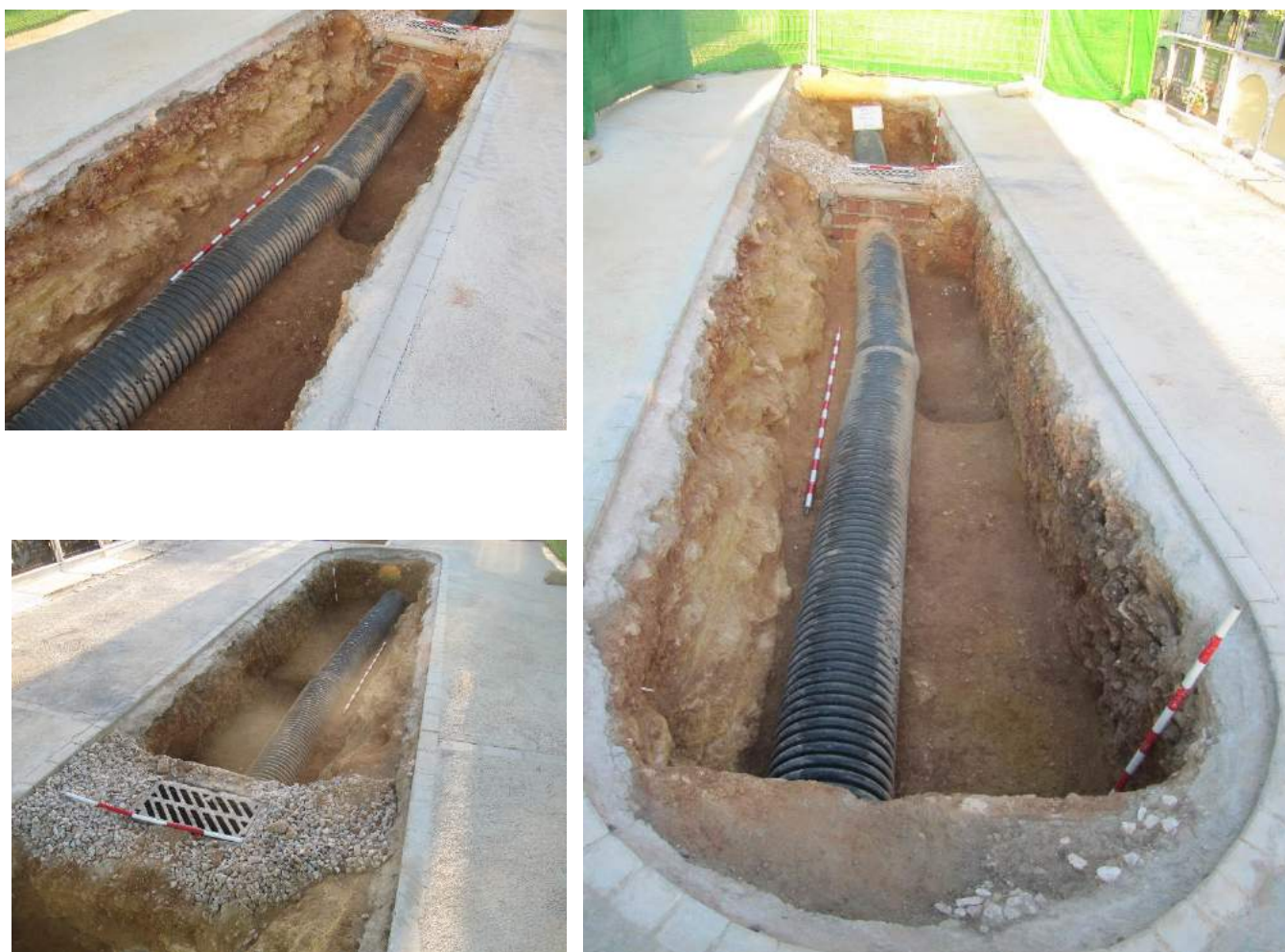
Fig. 5.15.- Fig. 5.16 y Fig. 5.17.- Sondeo 3. Obsérvese la afección de la red de saneamiento sobre la fosa.
