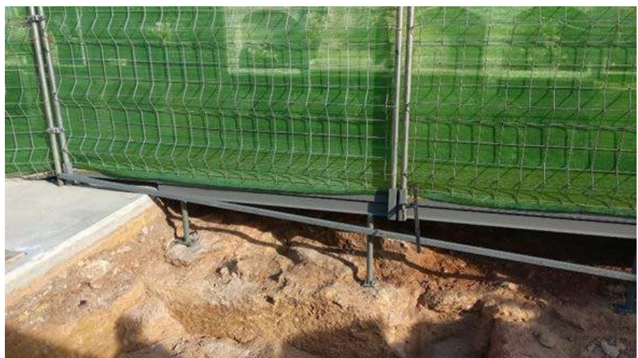
Fig. 7.13.- Estructura metálica anclada en el alcor para la colocación de una pasarela de acceso a los nichos.
