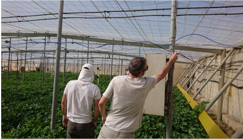
Figura 83. Instalación completa de sistema de medida en invernadero (X).
