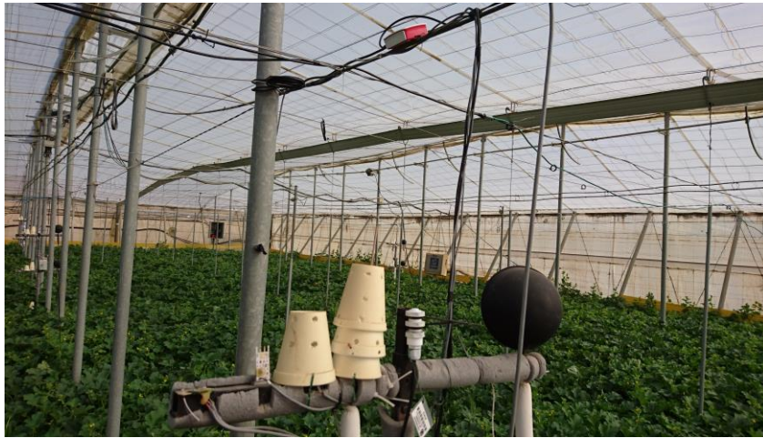
Figura 110. Instalación completa de sistema de medida en invernadero (XXXVII).
