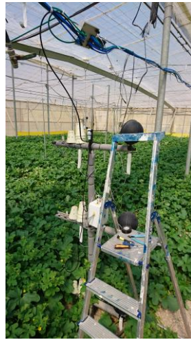
Figura 90. Instalación completa de sistema de medida en invernadero (XVII).
