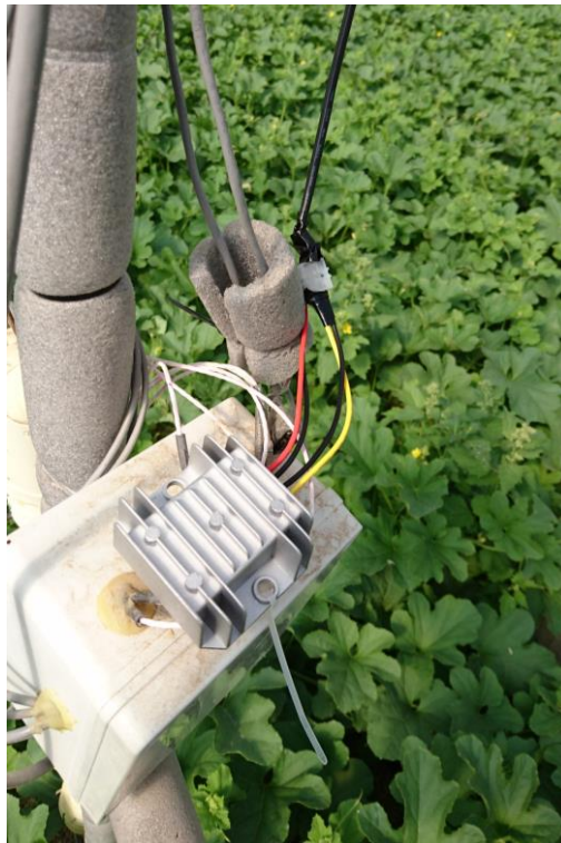
Figura 102. Instalación completa de sistema de medida en invernadero (XXIX).
