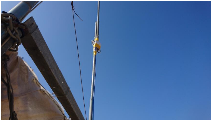
Figura 126. Instalación completa de sistema de medida en invernadero. Montaje sensor UVI exterior (XII).
