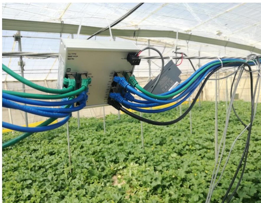
Figura 96. Instalación completa de sistema de medida en invernadero (XXIII).
