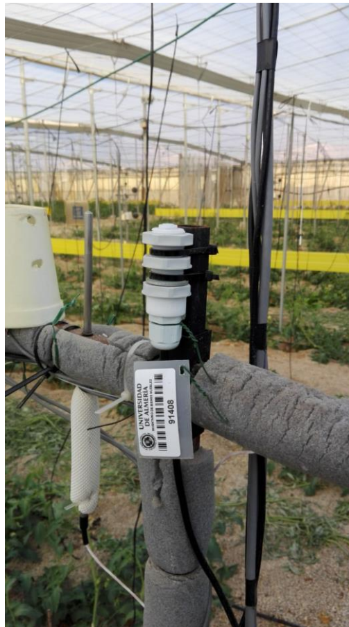
Figura 142. Mantenimiento semanal del sistema de medida (VII).
