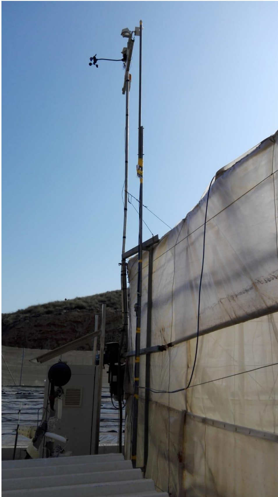
Figura 130. Instalación completa de sistema de medida en invernadero. Montaje sensor UVI exterior (XVI).
