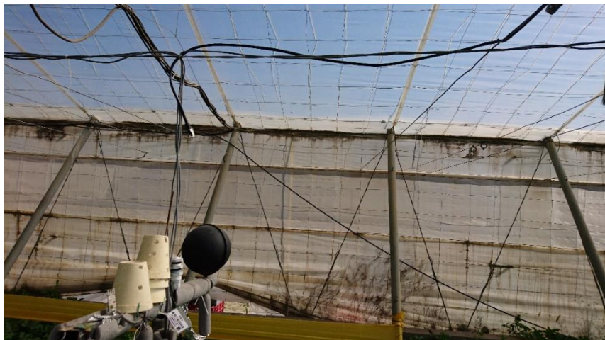
Figura 85. Instalación completa de sistema de medida en invernadero (XII).
