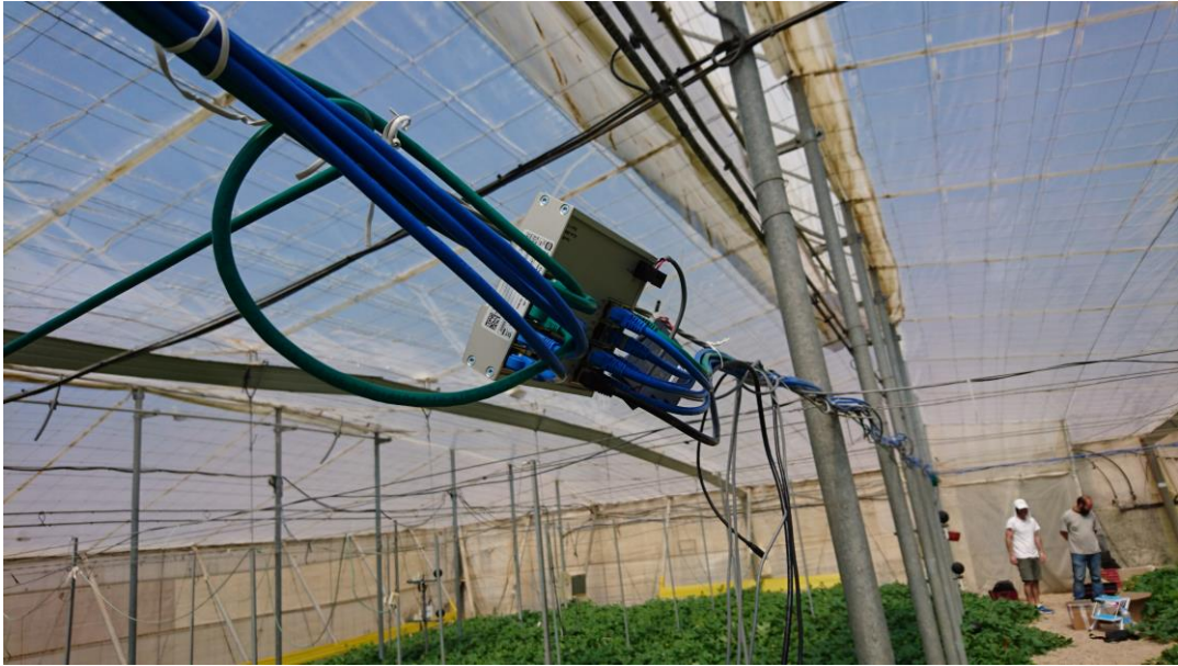
Figura 97. Instalación completa de sistema de medida en invernadero (XXIV).
