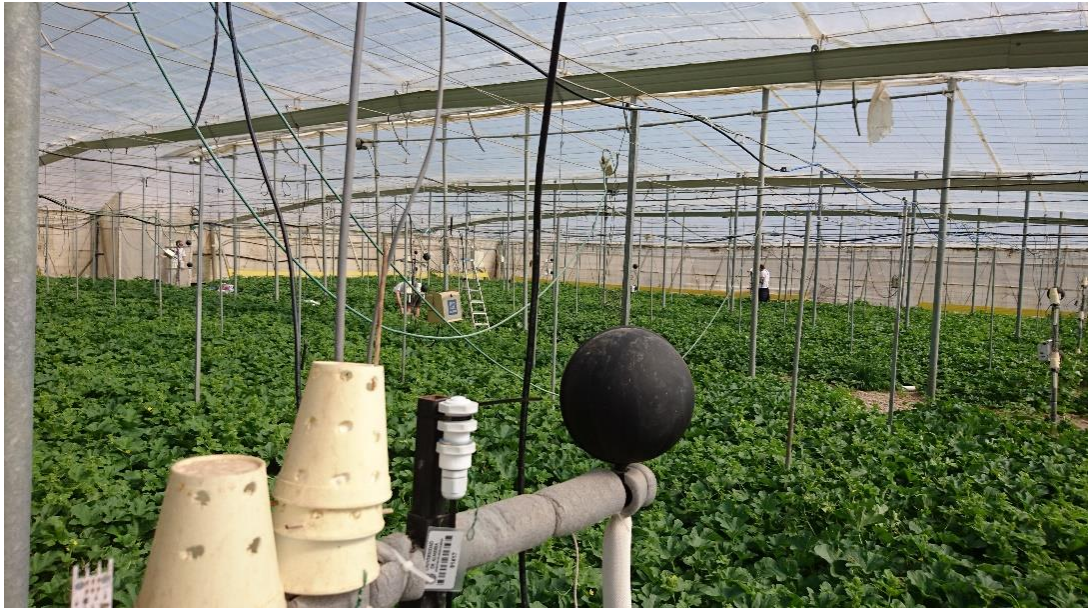
Figura 101. Instalación completa de sistema de medida en invernadero (XXVIII).
