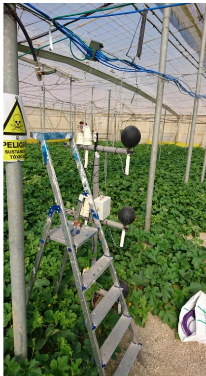
Figura 98. Instalación completa de sistema de medida en invernadero (XXV).
