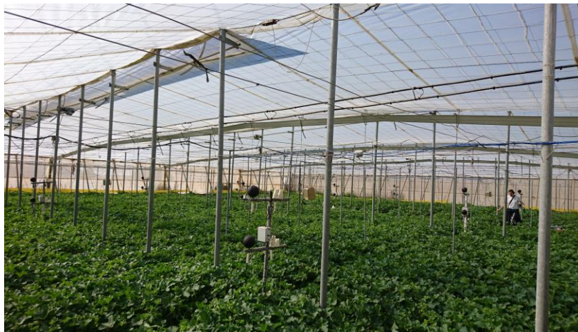
Figura 87. Instalación completa de sistema de medida en invernadero (XIV).
