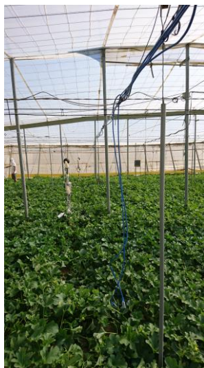
Figura 77. Instalación completa de sistema de medida en invernadero (IV).
