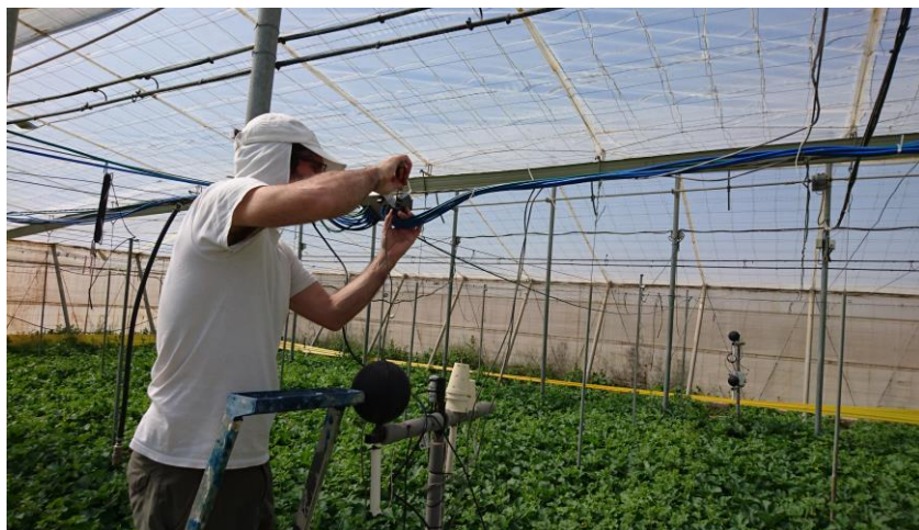
Figura 91. Instalación completa de sistema de medida en invernadero (XVIII).
