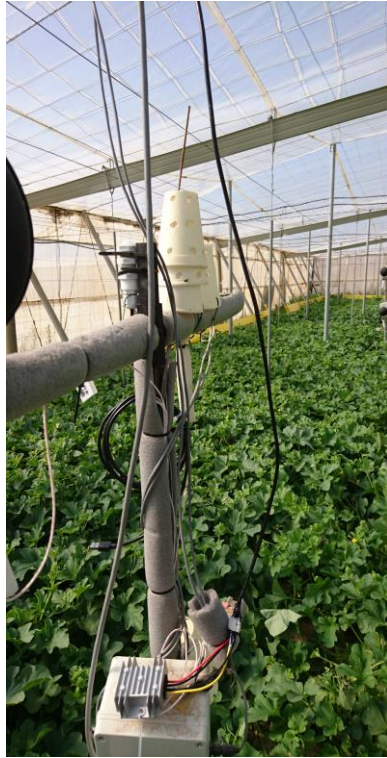
Figura 103. Instalación completa de sistema de medida en invernadero (XXX).
