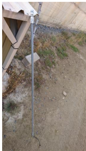
Figura 117. Instalación completa de sistema de medida en invernadero. Montaje sensor UVI exterior (III).
