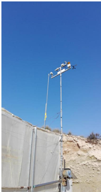
Figura 129. Instalación completa de sistema de medida en invernadero. Montaje sensor UVI exterior (XV).
