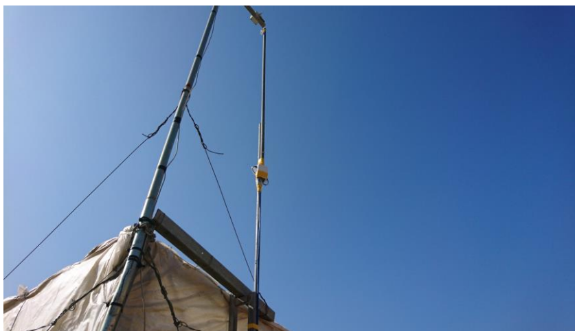
Figura 127. Instalación completa de sistema de medida en invernadero. Montaje sensor UVI exterior (XIII).
