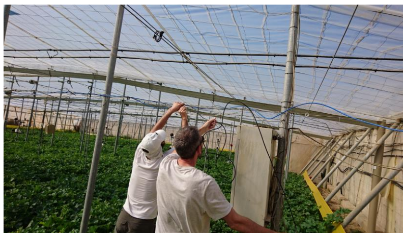
Figura 75. Instalación completa de sistema de medida en invernadero (II).
