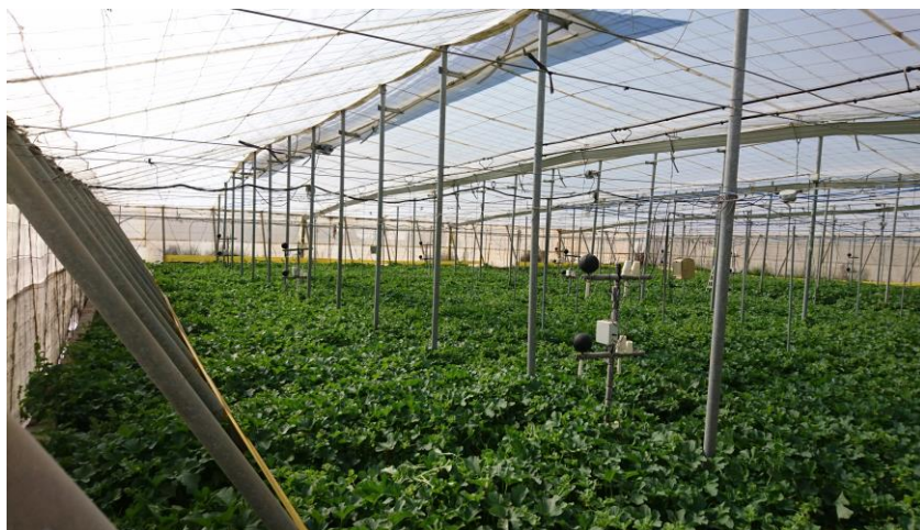
Figura 88. Instalación completa de sistema de medida en invernadero (XV).
