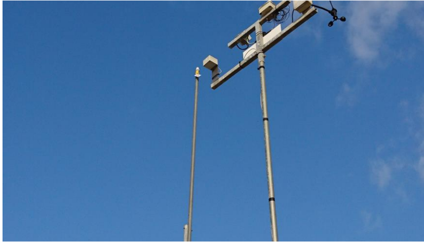
Figura 125. Instalación completa de sistema de medida en invernadero. Montaje sensor UVI exterior (XI).
