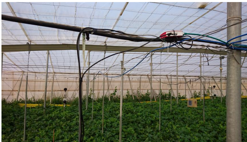
Figura 109. Instalación completa de sistema de medida en invernadero (XXXVI).
