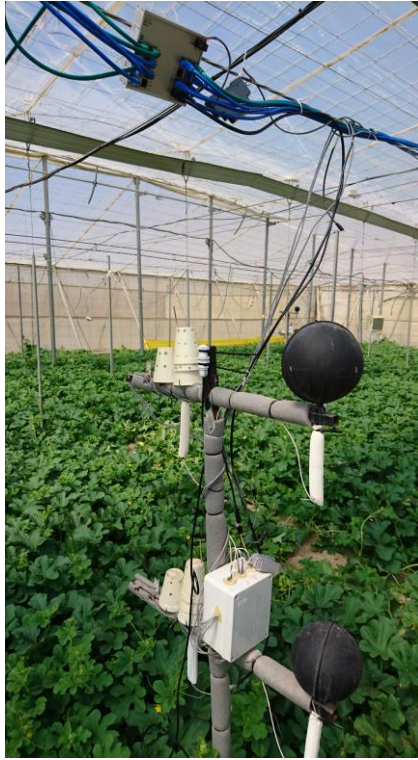
Figura 99. Instalación completa de sistema de medida en invernadero (XXVI).
