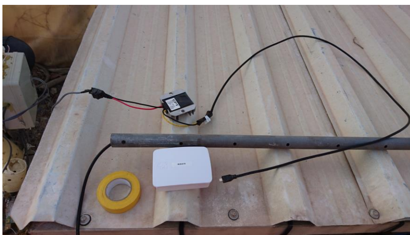
Figura 119. Instalación completa de sistema de medida en invernadero. Montaje sensor UVI exterior (V).
