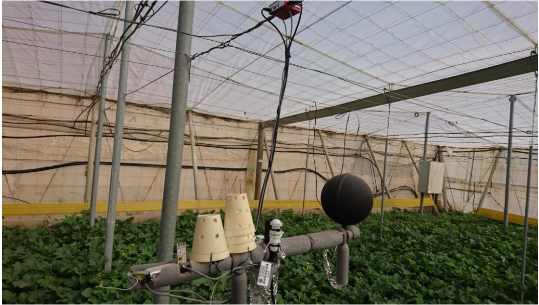
Figura 113. Instalación completa de sistema de medida en invernadero (XL).
