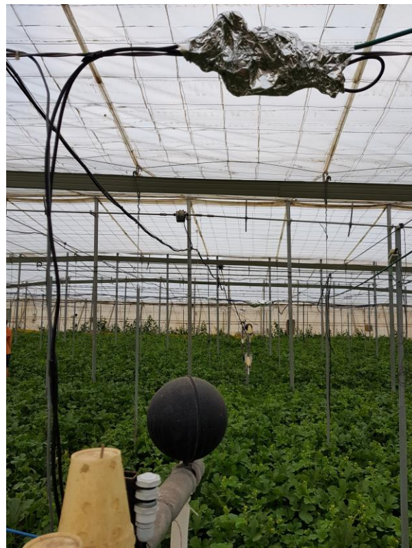
Figura 132. Mantenimiento semanal del sistema de medida (II).
