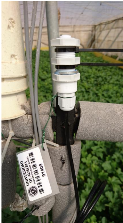
Figura 100. Instalación completa de sistema de medida en invernadero (XXVII).
