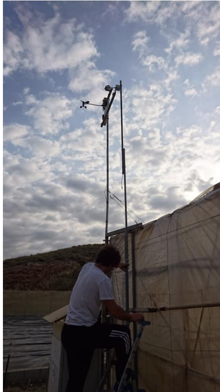
Figura 121. Instalación completa de sistema de medida en invernadero. Montaje sensor UVI exterior (VII).
