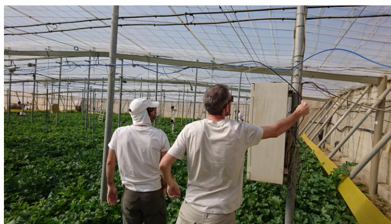
Figura 76. Instalación completa de sistema de medida en invernadero (III).
