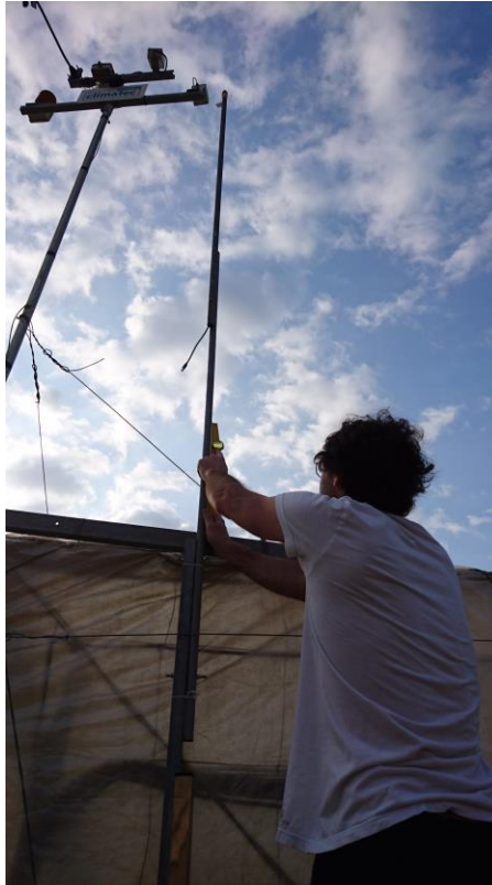
Figura 123. Instalación completa de sistema de medida en invernadero. Montaje sensor UVI exterior (IX).
