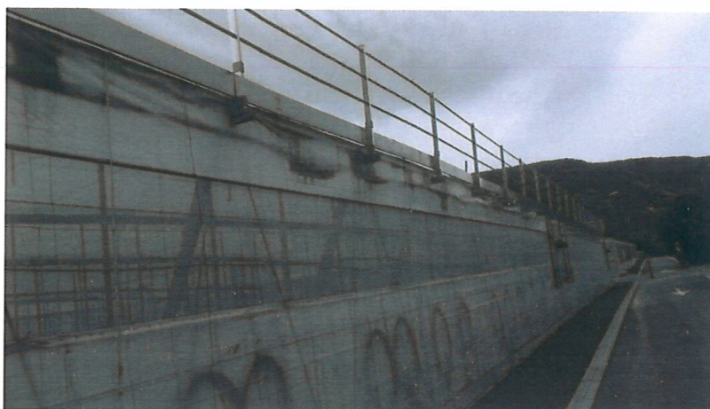
Figura 63. Sistema de protección de borde de barandillas instalado en la vertiente Norte
