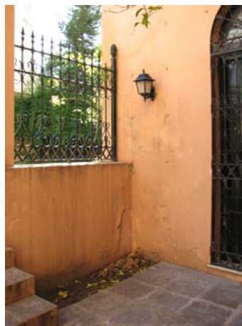
PC08_ Deterioro de revestimientos. Humedades de capilaridad..
