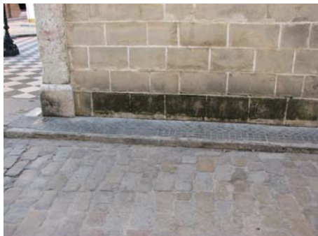
PC07_ Biodeterioro. Humedades de capilaridad.
