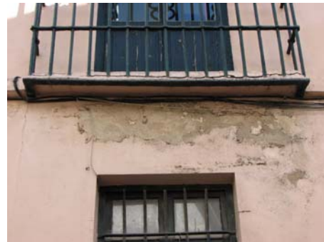
PC04_Deterioro del revestimiento por humedades.
