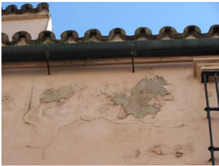
PC01_Deterioro de revestimientos, eflorescencias y humedades.
