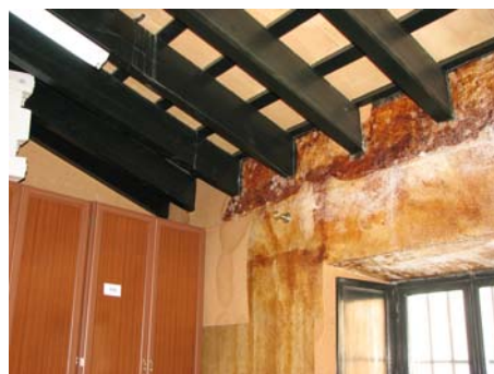
PC10_ Humedades de infiltración. Deterioro de revestimientos y eflorescencias.
