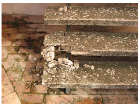
PC11_ Roturas por corrosión de armaduras.
