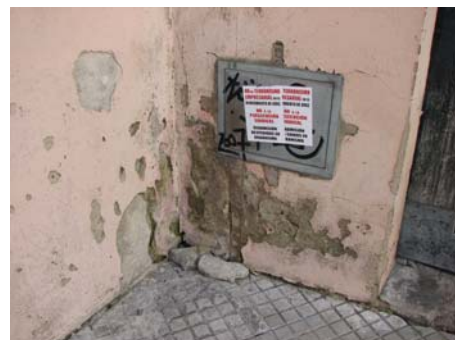
PC06_Deterioros por humedades de capilaridad.
