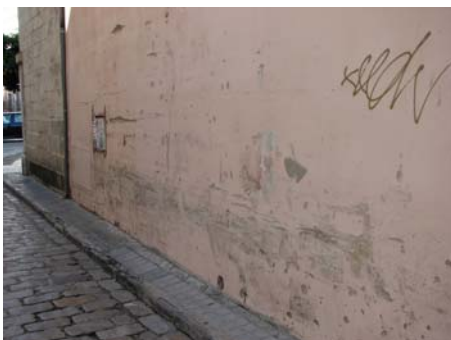
PC05_Erosión física. Humedades de capilaridad.
