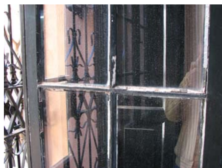
PC12_ Pérdidas de masilla de ajunquillado.
