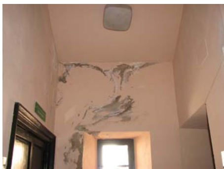
PC09_ Humedades de infiltración. Deterioro de revestimientos y eflorescencias.
